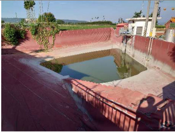
時間：112 年 11 月 17 日 說明：P16 池屬不透水蓄水池
